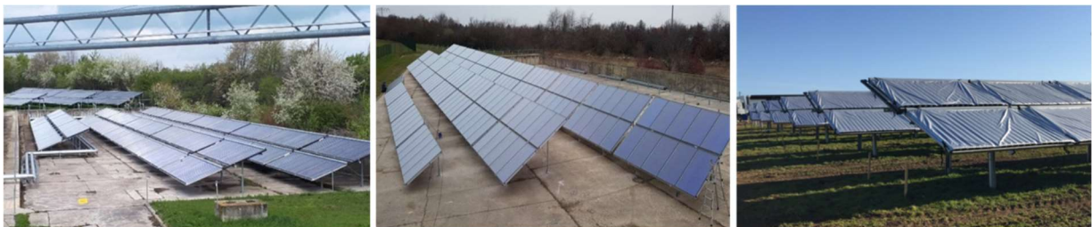
Abbildung 14: Solarthermie-Anlagen in Erfurt und Mühlhausen 77
